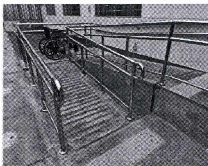
Figura N° 23. Barandas, pasamanos y elementos de protección Corrido horizontal de protección en rampas.
